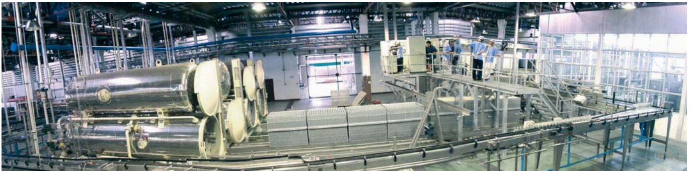
Vollautomatische Sterilisationsanlage Automated batch retort system / Thailand
